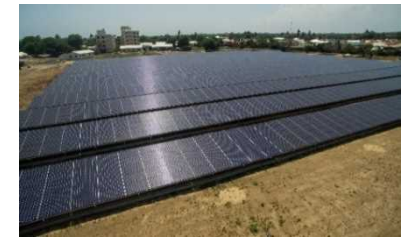
製塩工場横に設置された太陽光パネル (ケニア)
